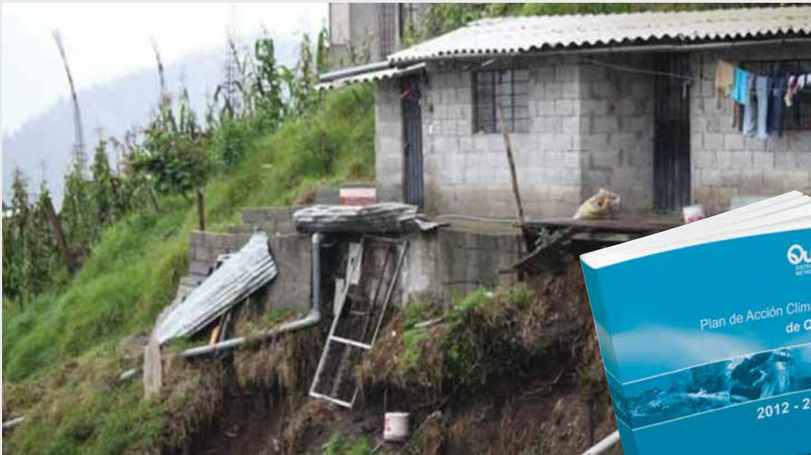
Construcciones inadecuadas en pendientes © Agencia Pública de Noticias de Quito
