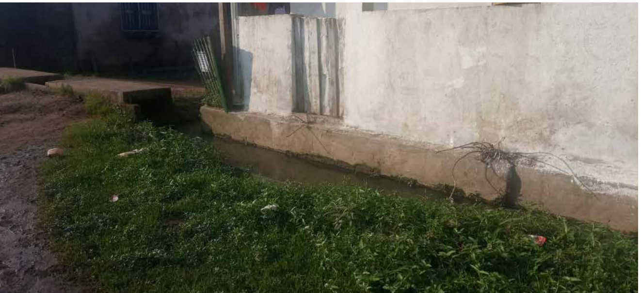
Photo 12. Canal de drainage comportant de l'eau stagnante Source : ONU-Habitat
