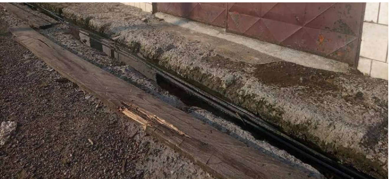
Photo 13. Une gouttière de drainage des eaux pluviales Source : ONU-Habitat
