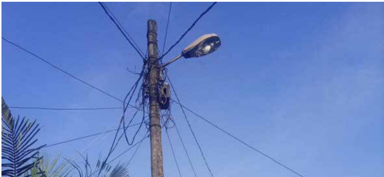
Photo 24. Le raccordement informel en "toile d'araignée" au réseau électrique à Mambanda Source : ONU-Habitat
